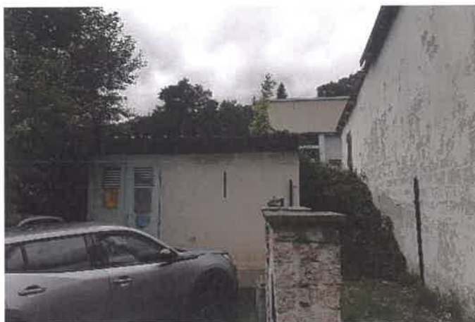
Transformateur hors parcelle situé à proximité du bâti à démolir
