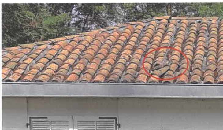
Tuiles instables en surface de la couverture fibrociment
