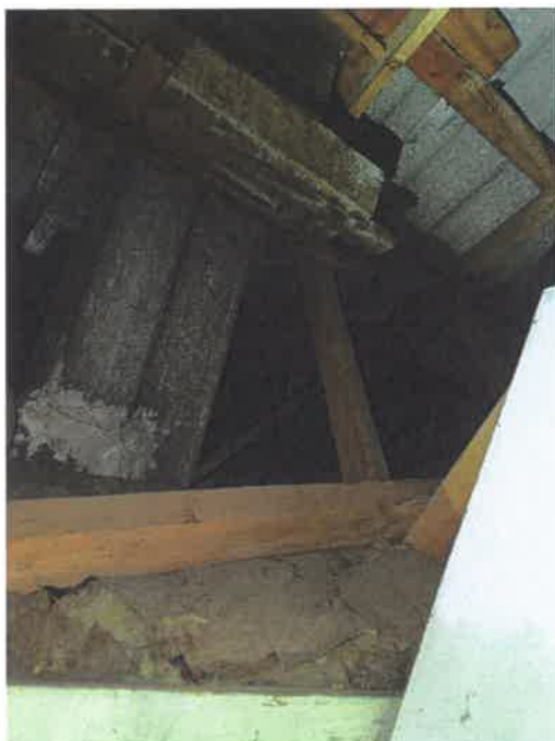
Panneaux de fibrociment et conduit de cheminée amiantés
